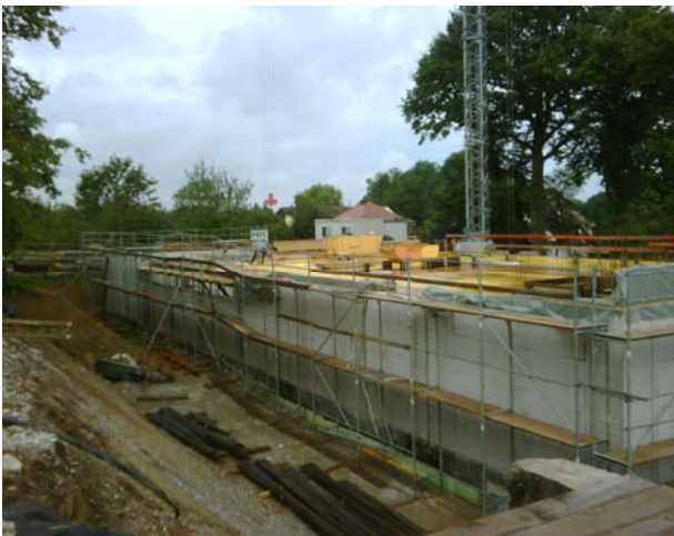
Blick nach Nordwesten (mit Außendämmung des EG-Bereichs, dieser Bereich wird später verfüllt)
